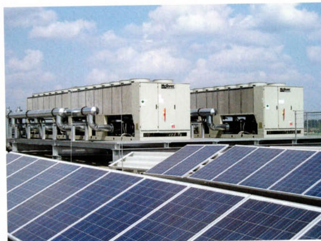
Die beiden Mc/Quay-Flüssigkeitskühler auf dem Dach des Edeka-Frischezentrums in Heddesheim
