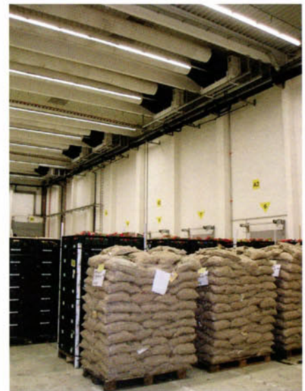
Blick in das Kühlager
